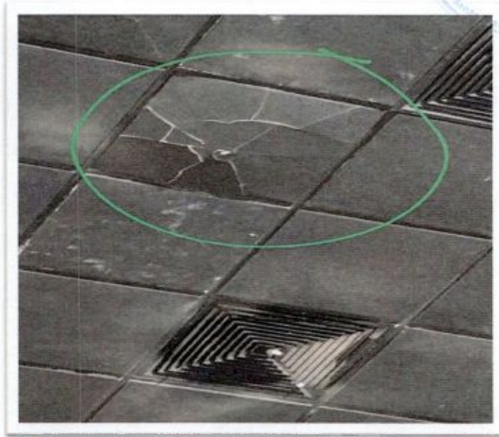
Ilustración 6, falso techo de plafón afectado por impactos, imagen disponible en el informe pericial SDFIF-0482-2025, celular entregado voluntariamente por Manuel Jiménez Mateo.
