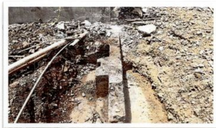
Foto de la zapata de la columna eliminada del lado del escenario. Imagen obtenida del Informe Preliminar Técnico Pericial de la edificación Jet Set Club.
