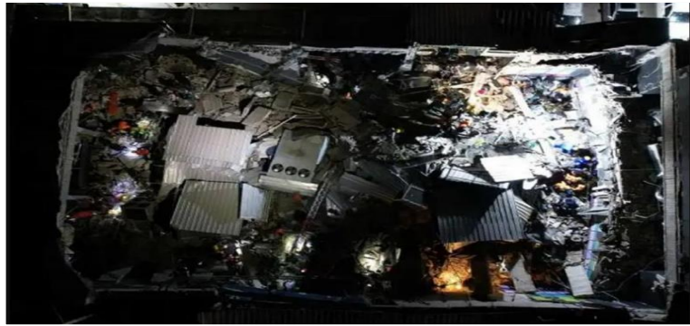
Condiciones de la discoteca Jet Set Club luego del desplome del techo.
