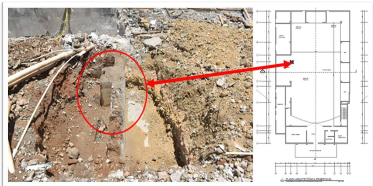
Columna eliminada en el escenario del local del Jet Set Club Imagen obtenida del informe técnico pericial de la edificación del Jet Set Club
