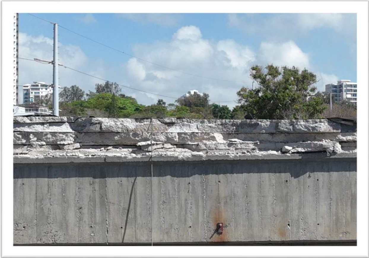
Distintas capas de finos identificados por los peritos. Imagen obtenida del Informe final técnico pericial: edificación Jet Set Club.
